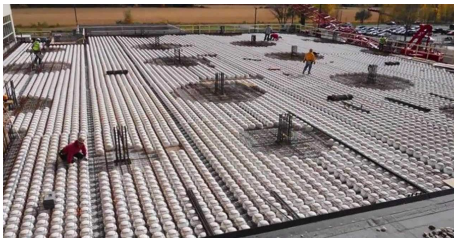
Рис. 2. Отсутствие пустообразователей в местах опор
